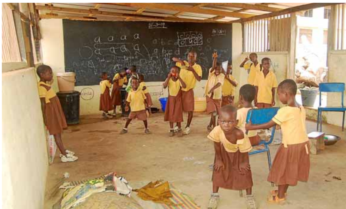
Imatge d'un dels interiors de les aules d'infantil. La classe és buida, no hi ha ni taules ni cadires, i les finestres no tenen vidres. Aquesta precarietat condiciona el nivell d'aprenentatge dels alumnes.
